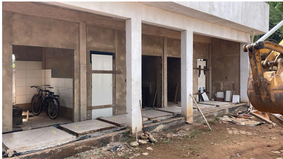
Figura 2: Central de Resíduos.
